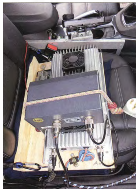
Bild 2: Endstufe mit Erdung, Zuleitungsdrösel, Sicherheitsseil und Steckverbinder
