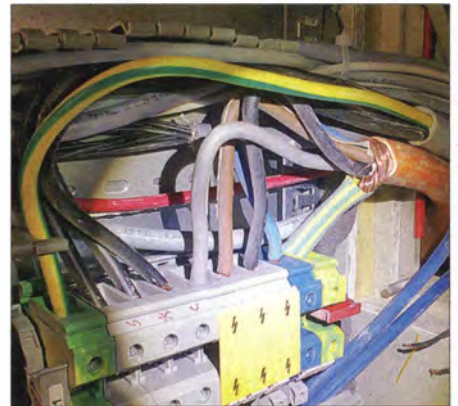
Bild 3: Klassischer Fehler; Klemmung der Energiezuleitung im Schaltschrank – der Kabelschirm liegt nicht großflächig auf dem Blech auf, sondern ist zu einem Zopf geflochten. Dieses als „pigtail“ bekannte Leitungsstück wirkt als „prima“ Viertelwellenstrahler für höhere Störfrequenzen.
