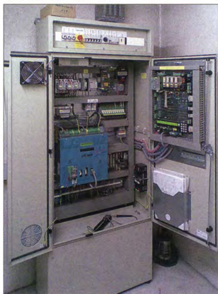
Bild 2: Moderner Schaltschrank eines Personenaufzugs; rechts an der Schaltschranktür die Mikroprozessorsteuerung, der blaue Kasten inmitten des Schranks ist der Frequenzumrichter für die Drehzahlregelung des Antriebsmotors.
