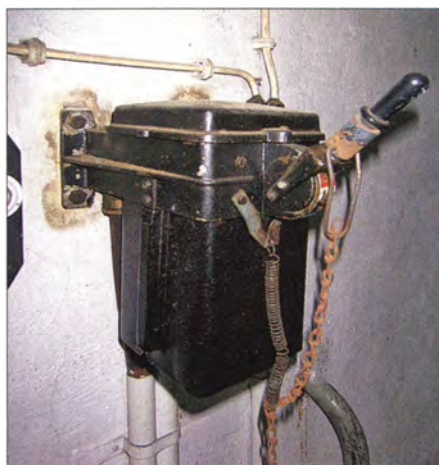
Bild 6: In ganz alten Anlagen sind auch noch sog. Ölschalter zu finden, die Kontakte sind zur Kühlung und Funkenlöschung von einem Ölbad umschlossen.
