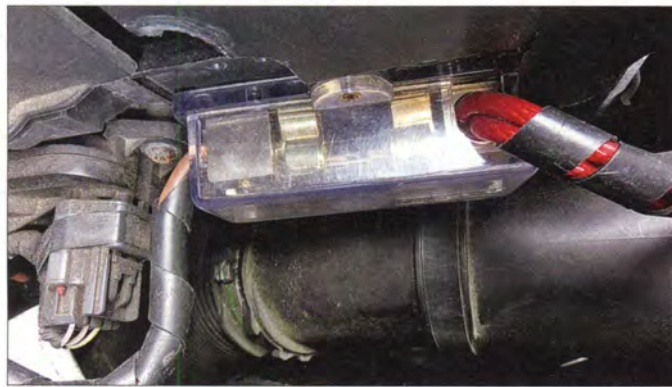
Bild 4: Kurzschlusschutz der Stromversorgungsleitungen im Motorraum
