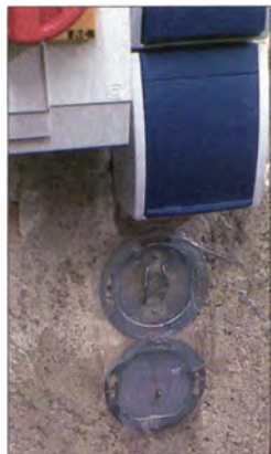
Bild 4: Wenns schnell gehen soll; vorhandene Schalter- und Steckdosen werden erst gar nicht mehr ausgebaut, sondern mit der Silikonkartusche ausgespritzt. So wirkt sich Preisdruck in der Praxis aus!
